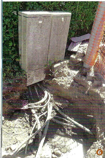
6 Stromkästen mit ihren unterirdischen Kabeln erzeugen elektrische Störfelder.
